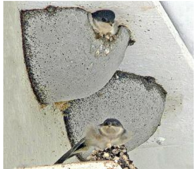
Typische (vorgezogene) Ausgleichsmaßnahme: Nisthilfe für Schwalben am verbleibenden baulichen Bestand bei Gebäudeabriss
